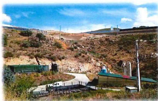
Figura 14 – Estação de Tratamento de Águas Lixiviantes
