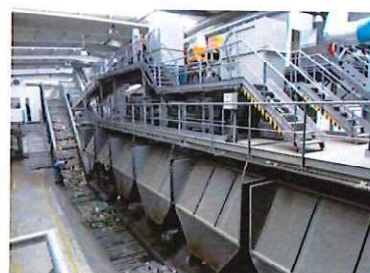
Figura 24 – Interior da UTMB
