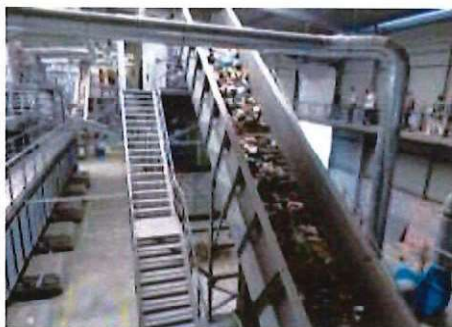
Figura 7– Linha de Alimentação da UTMB.
