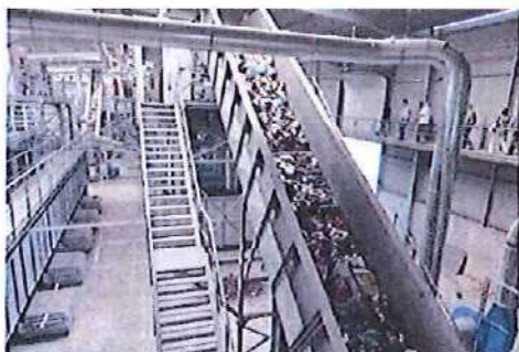
Figura 7– Linha de Alimentação da UTMB.
