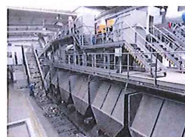
Figura 26 – Interior da UTMB
