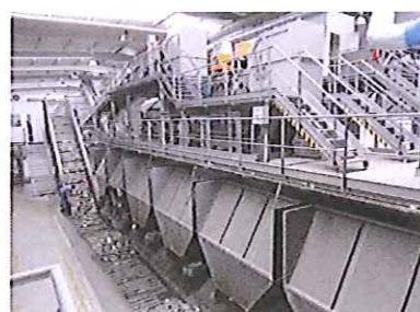
Figura 26 – Interior da UTMB
