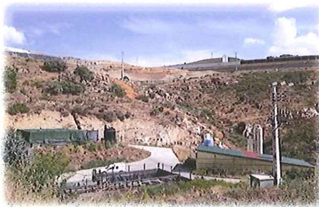
Figura 14 – Estação de Tratamento de Águas Lixiviantes
