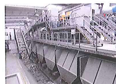
Figura 26 – Interior da UTMB.
