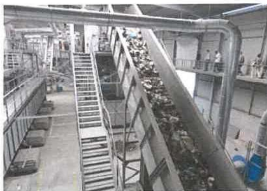
Figura 7– Linha de Alimentação da UTMB.
