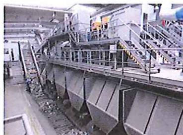
Figura 26 – Interior da UTMB.
