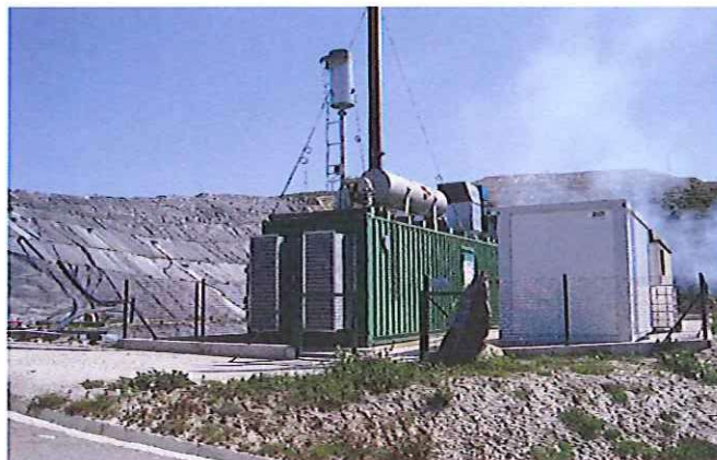
Fotografia da Central de Valorização Energética de Biogás
