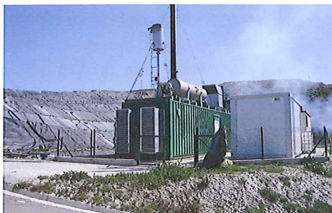
Fotografia 2 - Central de Valorização Energética de Biogás
